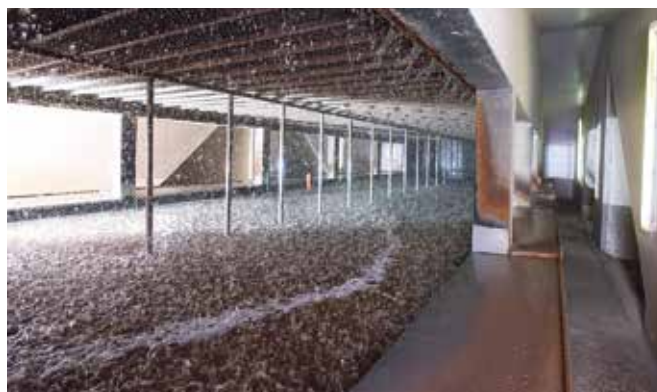
Luftindtag og opsamlingskar
